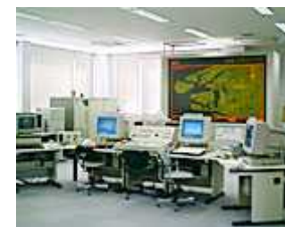
防潮岸集中監視装置
